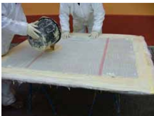
Fig. 17: Aplicar la resina sobre la parte posterior de la malla de fibra de vidrio
